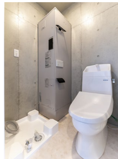
温水洗浄便座・電気温水器
