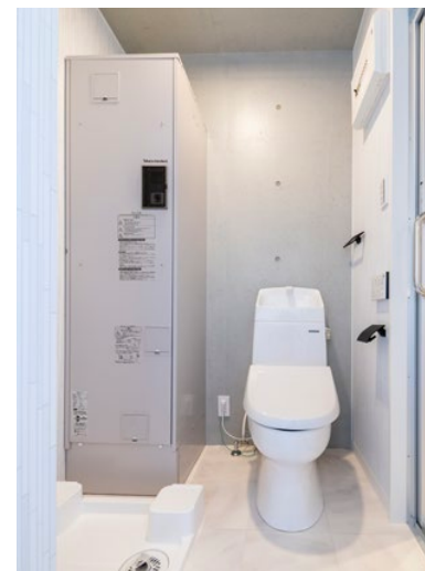
温水洗浄便座・電気温水器
